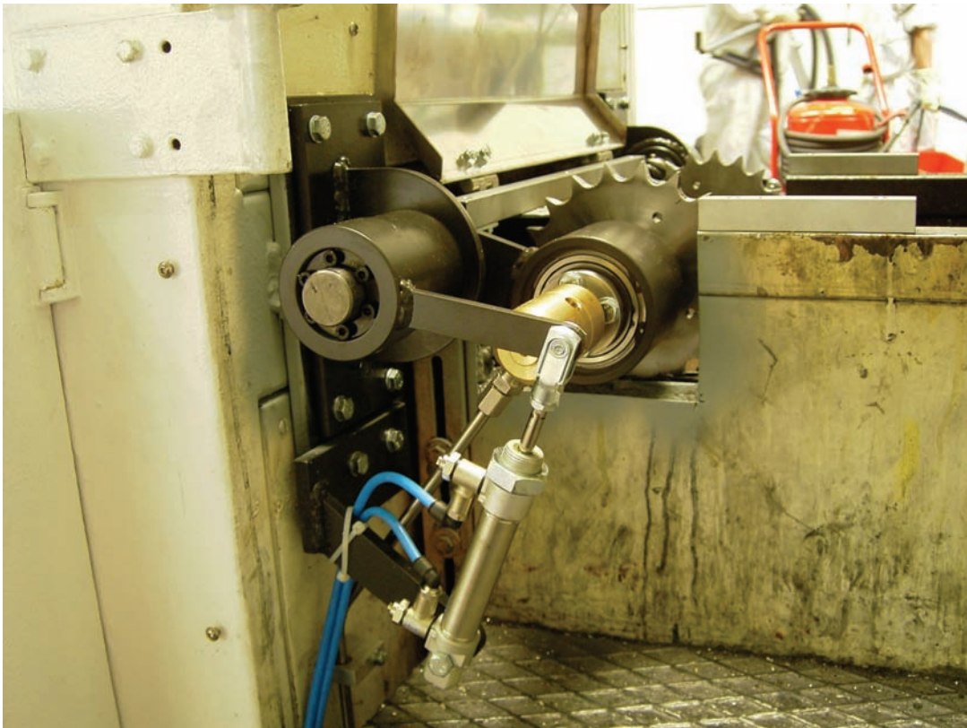
Beispiel einer nachgerüsteten Schmieranlage: Lagerung
