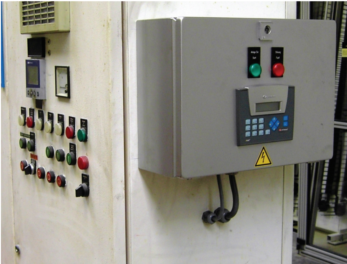
Beispiel einer nachgerüsteten Schmieranlage: Bedienpult
